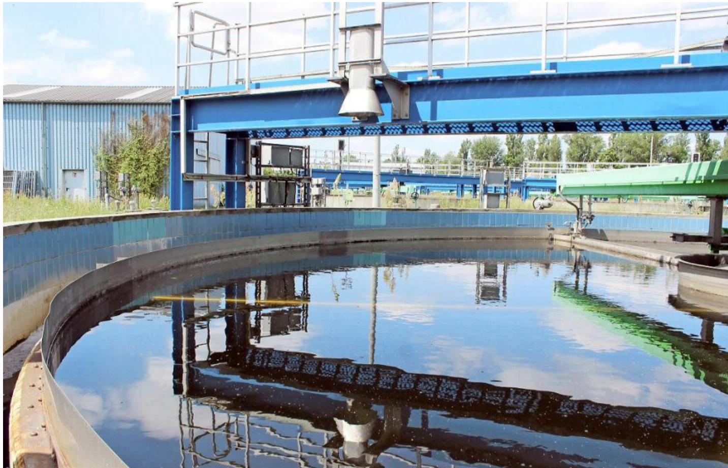
In diesem Becken in einem Klärwerk setzt sich der Schlamm auf dem Boden ab. Und siehe da, das Wasser wird sauber. Foto: Corinna Schwanhold, dpa
